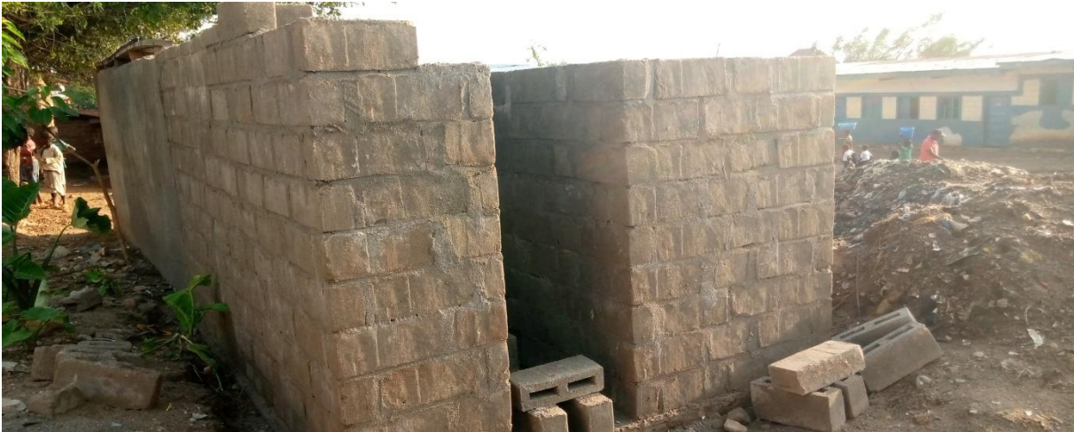
Photo tirée lors du chantier de réhabilitation de latrine de l'EP Ziwa dans l'Aire de santé de Kabindula
